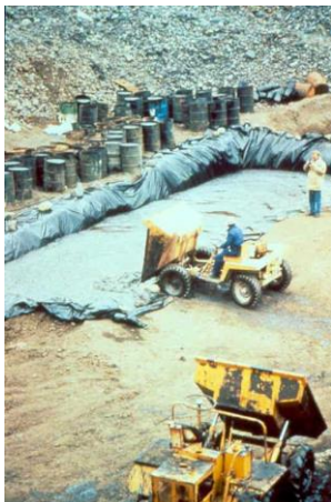
Slika 6: Improvizirana jama u rafinerije
