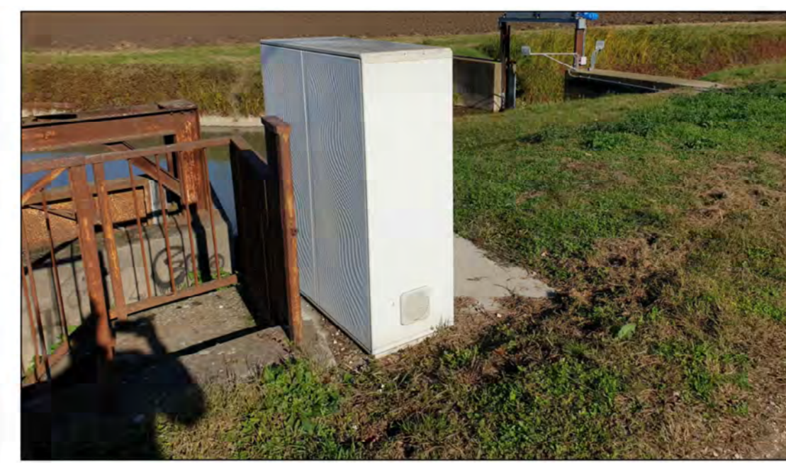
FOTO N.5 - Vista di un quadro elettrico simile a quello di progetto
