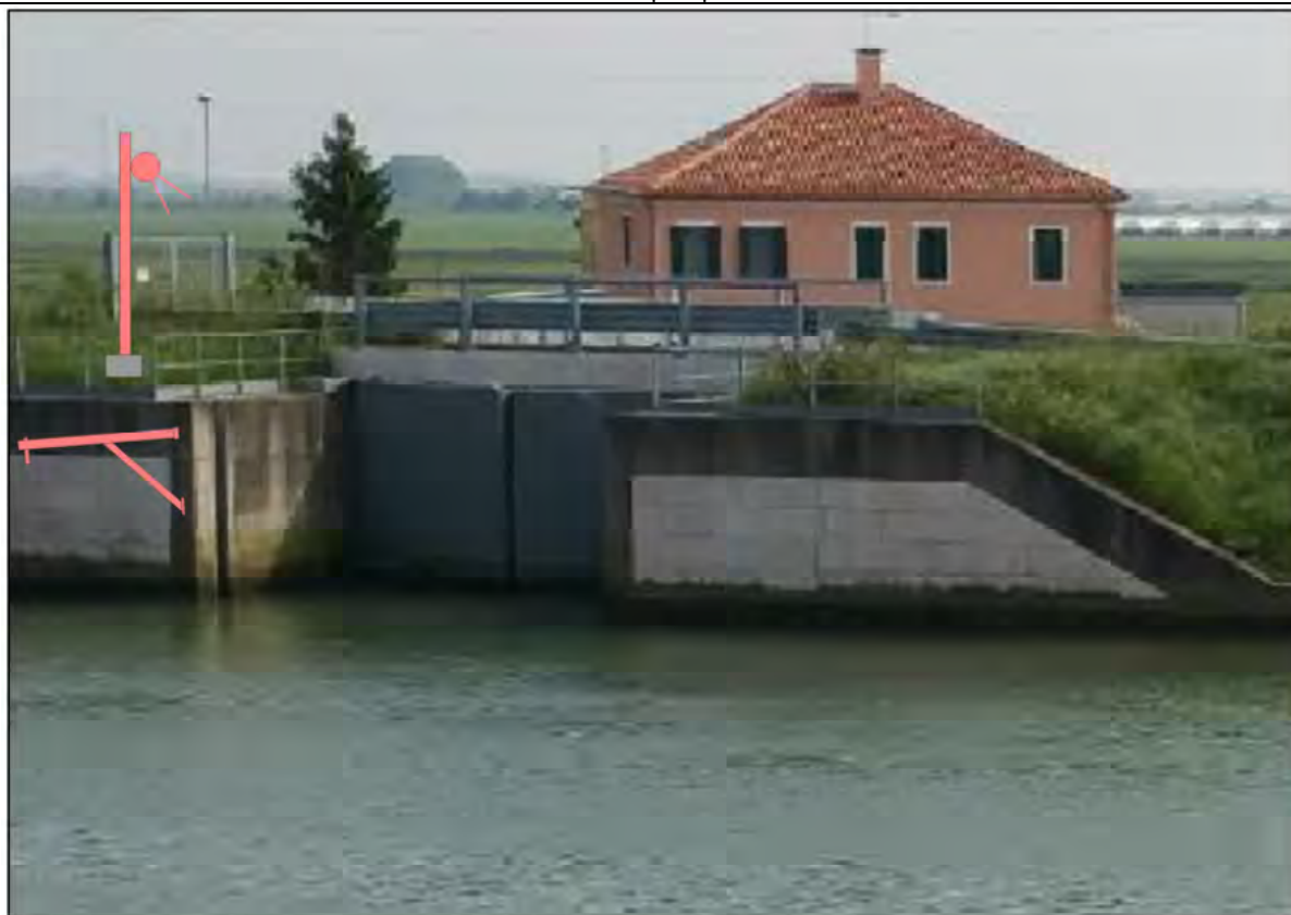
Foto 2: : Inserimento della staffa con sensore di livello e palo con web-cam nel prospetto di valle.-
