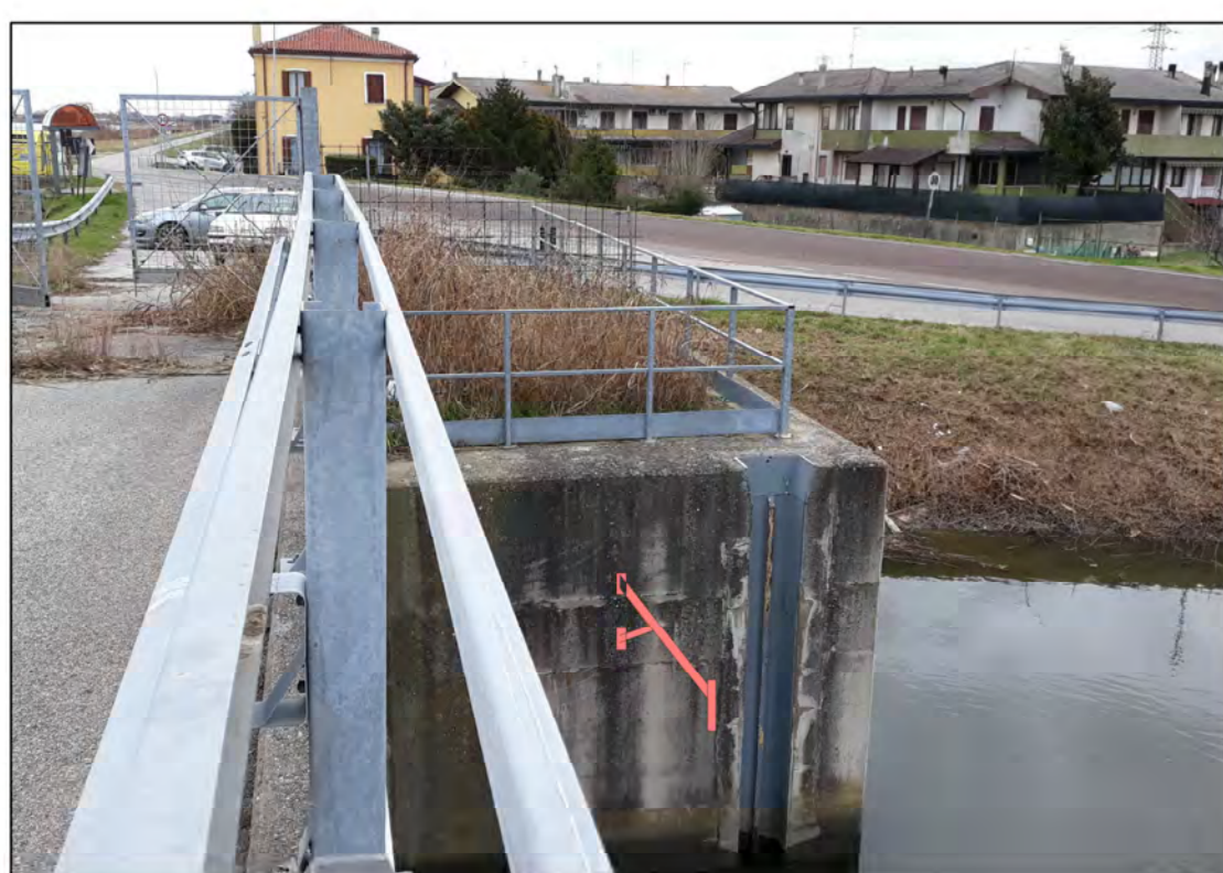
FOTO N.3 - Insetimento del sensore di livello prospetto di monte
