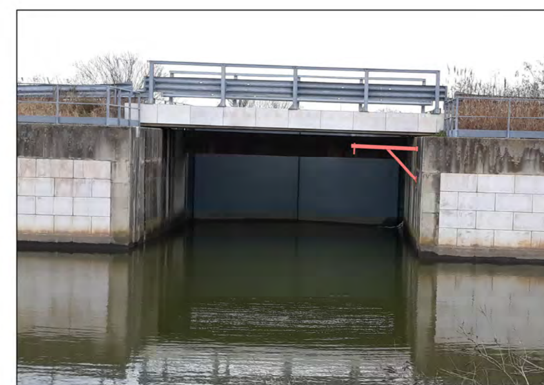
FOTO N.4 - Insetimento del sensore di livello prospetto di monte
