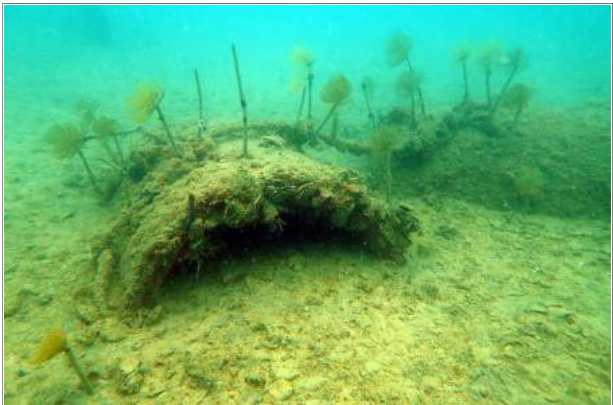
Foto 7: canaletta in calcestruzzo sprofondata nel sedimento
