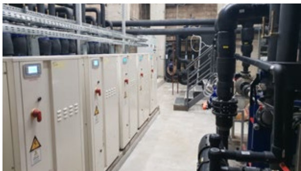
Slika 1. Pilot postrojenje dizalica topline na morsku vodu u Kneževom dvoru u Dubrovniku
