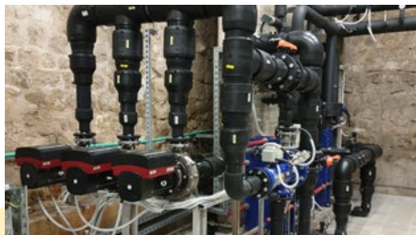
Slika 4. Šest toplinskih pumpi u sklopu pilot postrojenja u Kneževom dvoru
